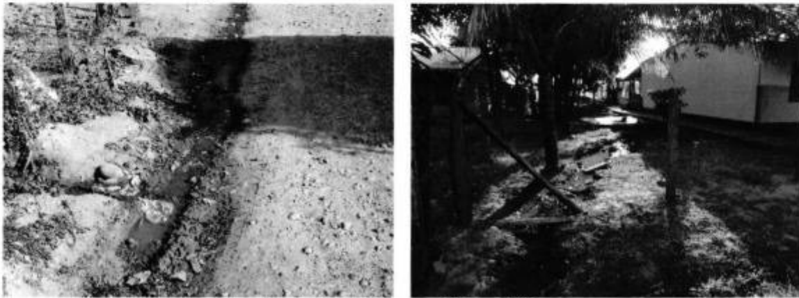
Imagen No. 10. Vertimiento de aguas residuales a la vía pública
